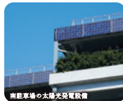
南駐車場の太陽光発電設備
