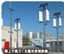
屋上の風力・太陽光発電設備
