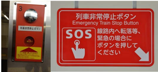
列車非常停止ボタンと案内板
