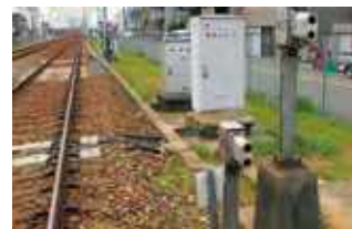
踏切障害物検知装置・発光器・受光器
