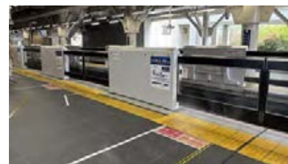
阪急西宮北口駅可動式ホーム柵
