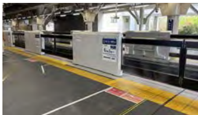
阪急西宮北口駅可動式ホーム柵
