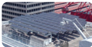
太陽光パネル
