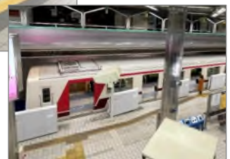
ホームドアが整備された駅 上：緑地公園駅 下：千里中央駅 (北大阪急行電鉄)
