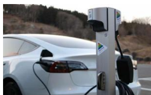
EV 充電設備
