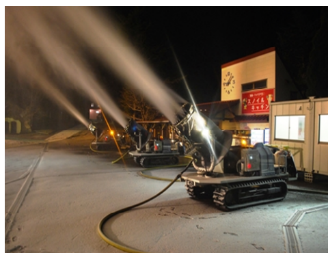
スノーファン 稼働時の様子
