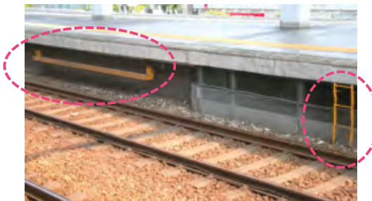
待避用ホームステップ （左側破線内がパー形式、右側破線内が梯子形式）
