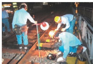
保安通信設備の定期検査
