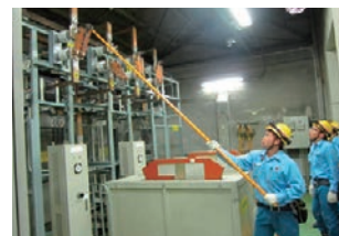
変電所の設備点検
