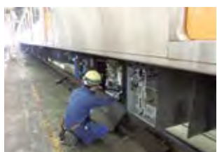
状態・機能検査（月検査）
