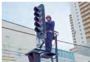
信号機の定期検査
